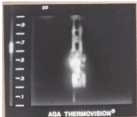
R-11 6 kV, poziom kablowy pole 12, faza S, temp. 30,3°C
